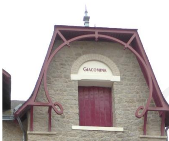
La charpente apparente assure la triangulation de la rive de toiture par un grand cercle
